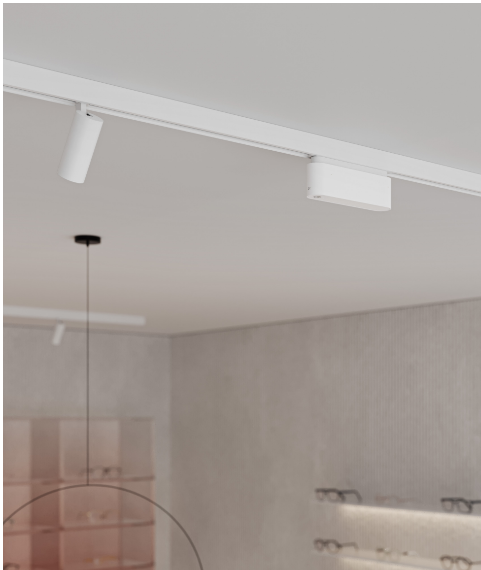
Rail en saillie plafond
